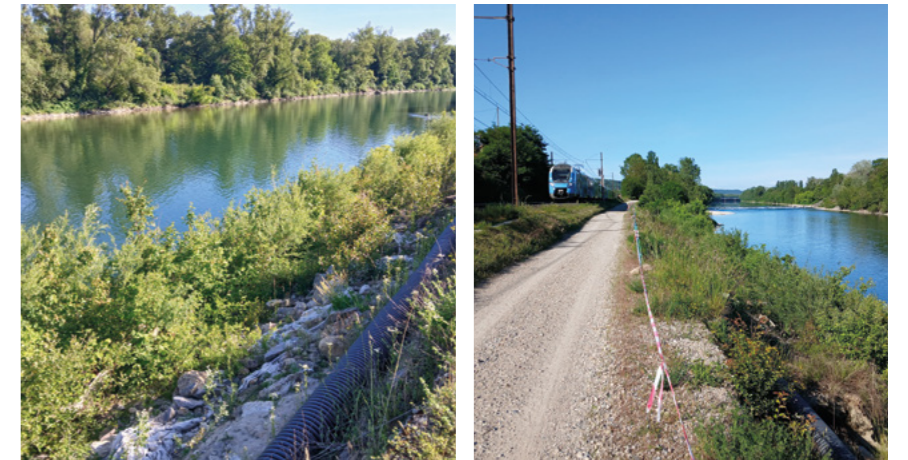
2,1 millions d'€ HT ENVIRON DE TRAVAUX ESTIMÉS POUR LA REPRISE DE LA BERGE
